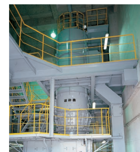
●資源ごみリサイクル施設に設置されたKE-400S
