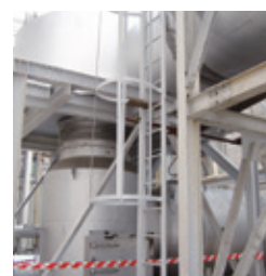
アフターバーナー Afterburner (Reheating Treated Gas)
