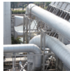
ダクトワーク Duct work
