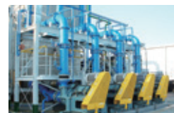
石膏スラリー循環ポンプ Gypsum slurry recirculation pump
